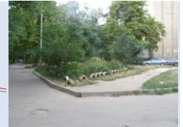
Відсутнє покриття пішохідної доріжки
