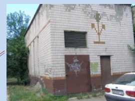
Непривабливий вигляд трансформаторної підстанції
