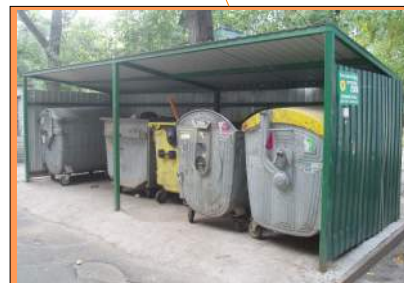
Неповністю закрита (огорожена, захищена) споруда навісу зміттєзбірного майданчика
