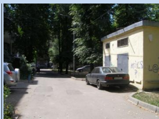
Фасад трансформаторної підстанції потребує впорядкування
